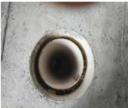
名称：车间与仓库下水管口 用途：在仓库和车间内边墙,用于收集消防废水
