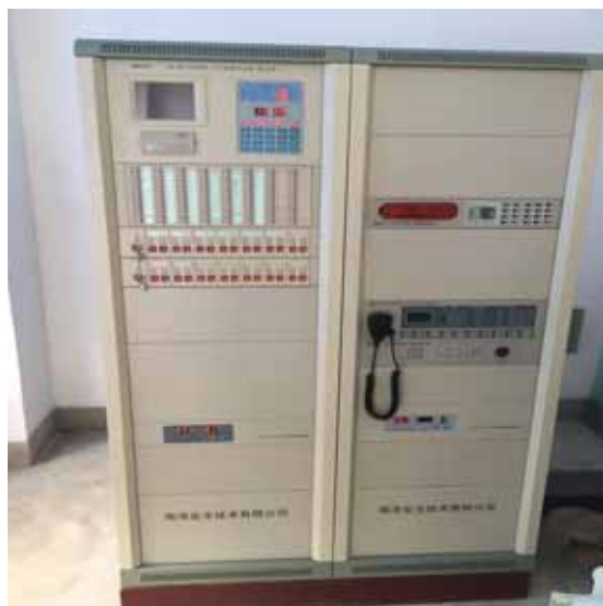
消防主控设备
