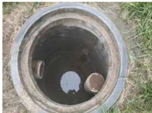
名称：水封井 用途：分离水与有机物并通过此管道收集至废水事故应急水池
