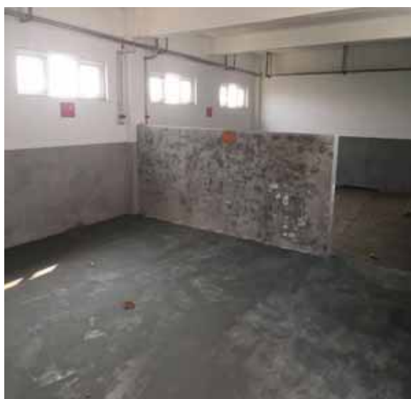
危废暂存间分区暂存
