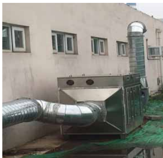
危废暂存间废气净化设备
